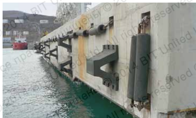
Монтаж причально-отбойных приспособлений для нефтеналивных танкеров под высокие динамические нагрузки (реконструкция нефтеналивного терминала РОСНЕФТЬ, г. Находка)
