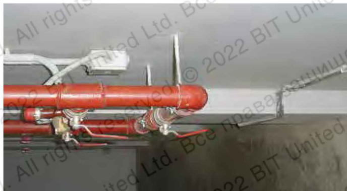
Монтаж трубопроводов высокого давления спринклерной системы пожаротушения к пустотелым плитам межэтажных перекрытий с применением сетчатых гильз
